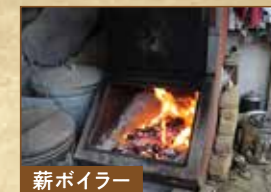
薪ボイラー お風呂や台所で使うお湯はここで、竹林の竹や燃えるゴミを利用して沸かしている
